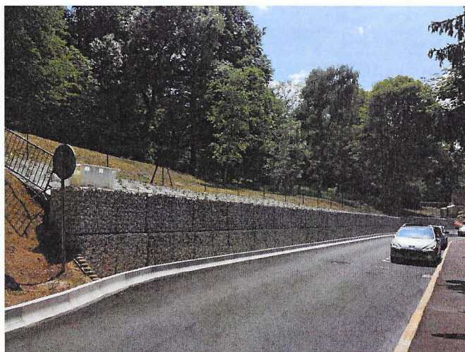
Rue de Colombet, le traitement routier de la voirie doit être accompagné d'un projet d'aménagement qualitatif
