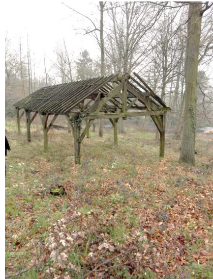
Figure 88: Détérioration progressive de la charpente en bois
